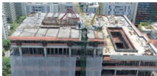
Mastro de concreto e cimbramentos especiais foram usados para agilizar produtividade na obra
