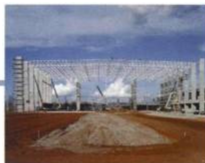
Visão frontal do hangar com seus 18 pilares em concreto executados "in loco"
